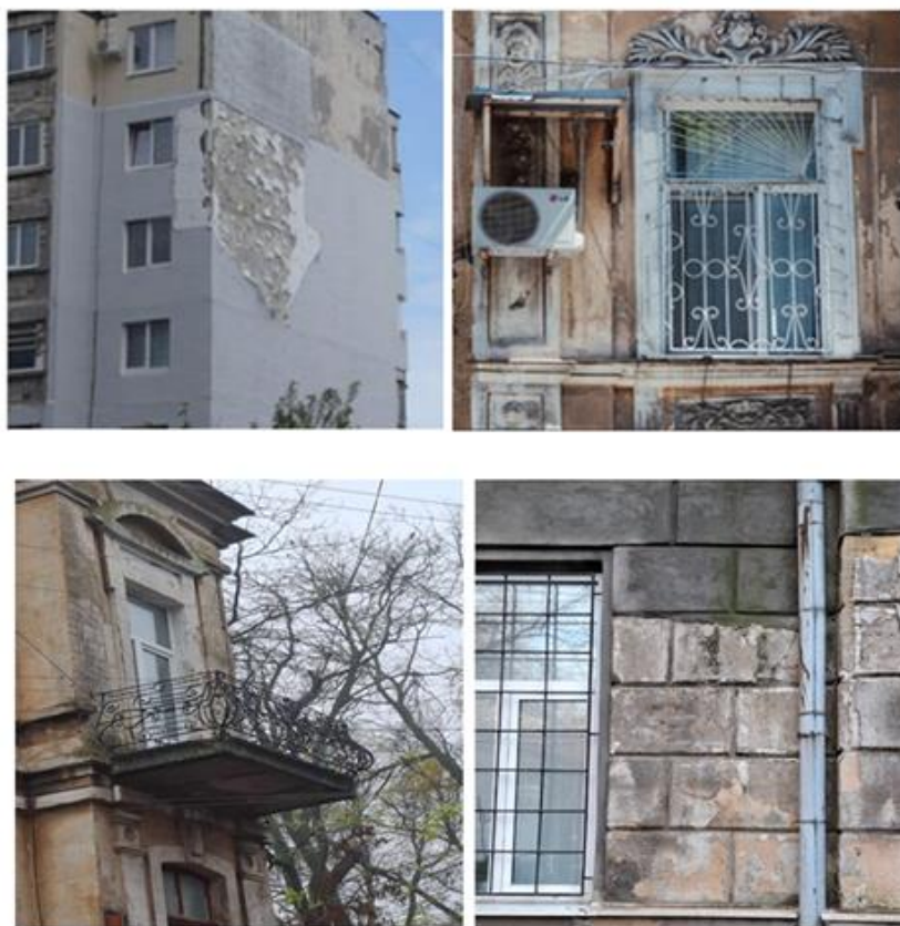
Рис. 2. Корозія та руйнування будівель м. Одеса
